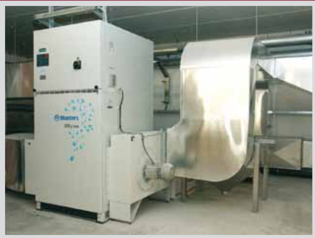
Vakuumtrockenluftförderung für PA-Granulat mit Wärmerückgewinnung / vacuum conveying by means of dry air for polyamid with heat recovery
