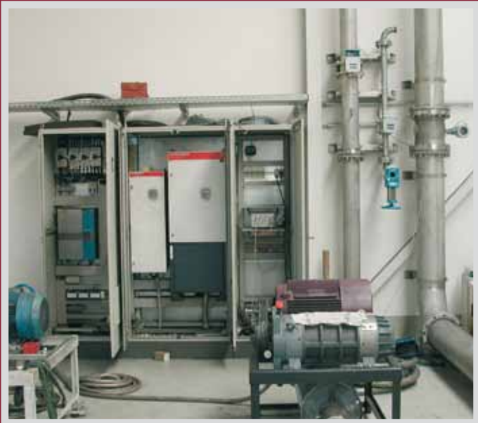
Prüffeld mit Frequenzumformer Vakuumdurchflussmessung bis 12000m 3 /h / test area with frequencyinverter and flow control up to 12000 m 3 /h
