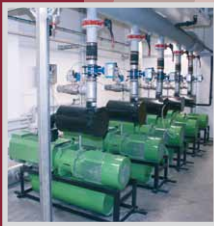
Vakuumzentralversorgung 5500 m 3 /h. Granulatförderung mit Wärmerückgewinnung aus der Abluft / centralized system 5500 m 3 /h. polyamid conveying with heat recovery.
